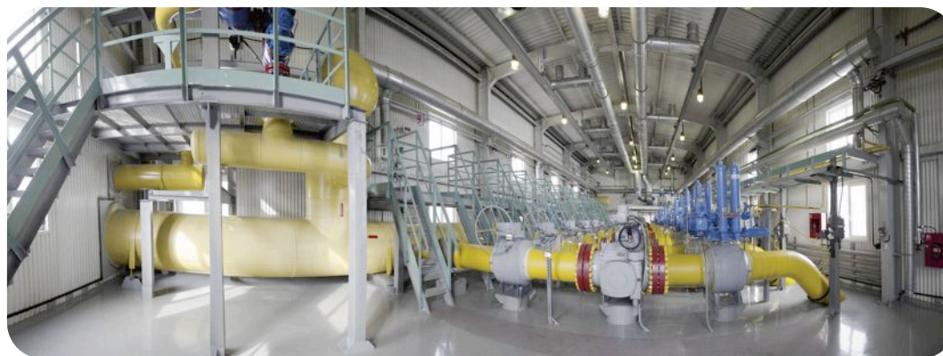
Gasproduktion ist Hightech pur: Im Bild eine Kompressorstation am russischen Feld Juschno Russoje.
