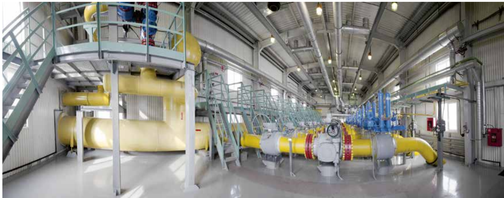
Gasförderung ist eine komplexe Angelegenheit mit vielen Komponenten. Im Bild eine Kompressorstation im russischen Feld Juschno Ruskoje.
