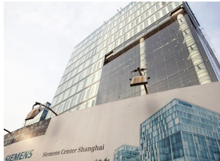
Siemens Center in Shanghai: eine Referenz für energieeffizientes Bauen. © Siemens AG
