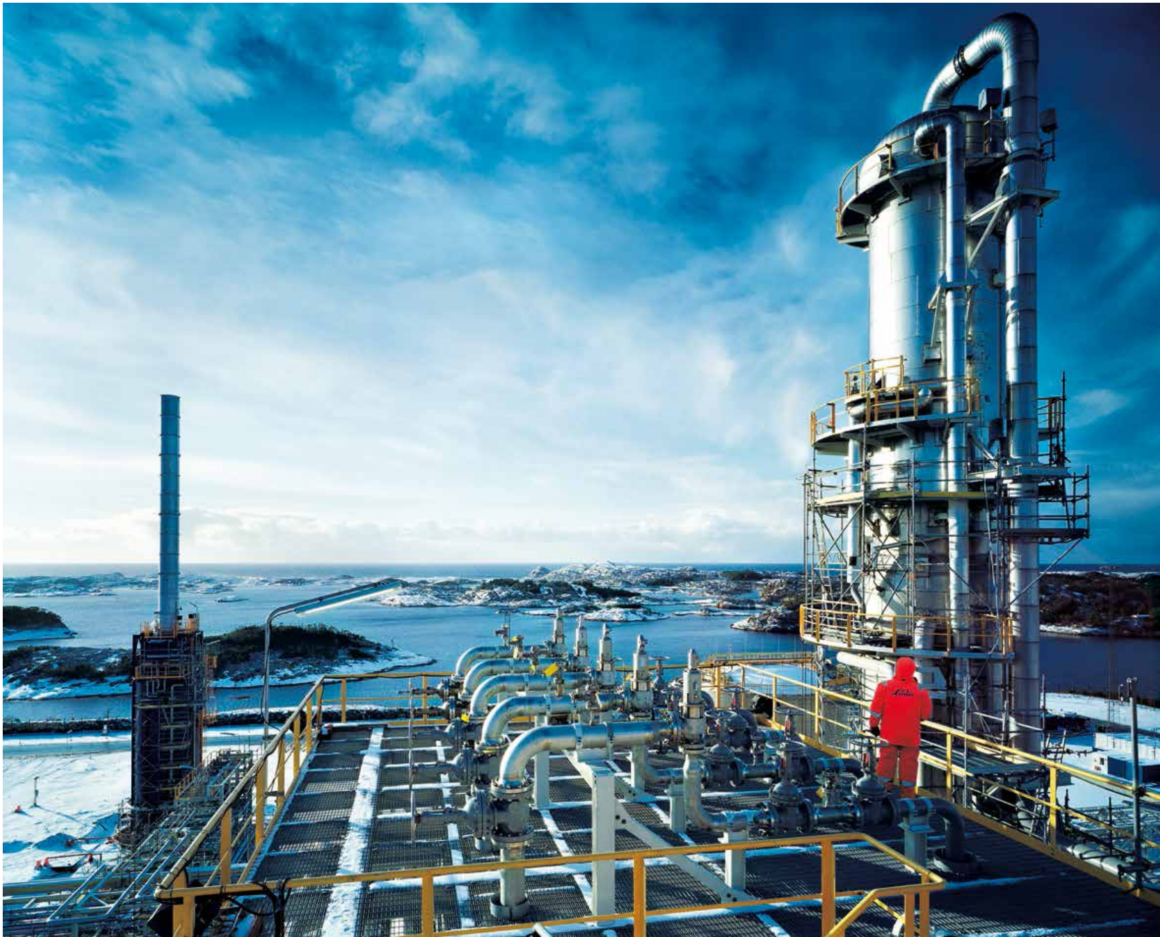
Linde-Anlagentechnologie an der norwegischen Westküste: In Kollsnes wird umweltfreundliches Liquefied Petroleum Gas produziert.
