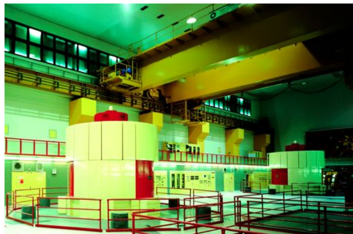
Maschinenhalle des Wasserkraftwerkes (2 x 325 MW) in Dlouhé Stráně.
