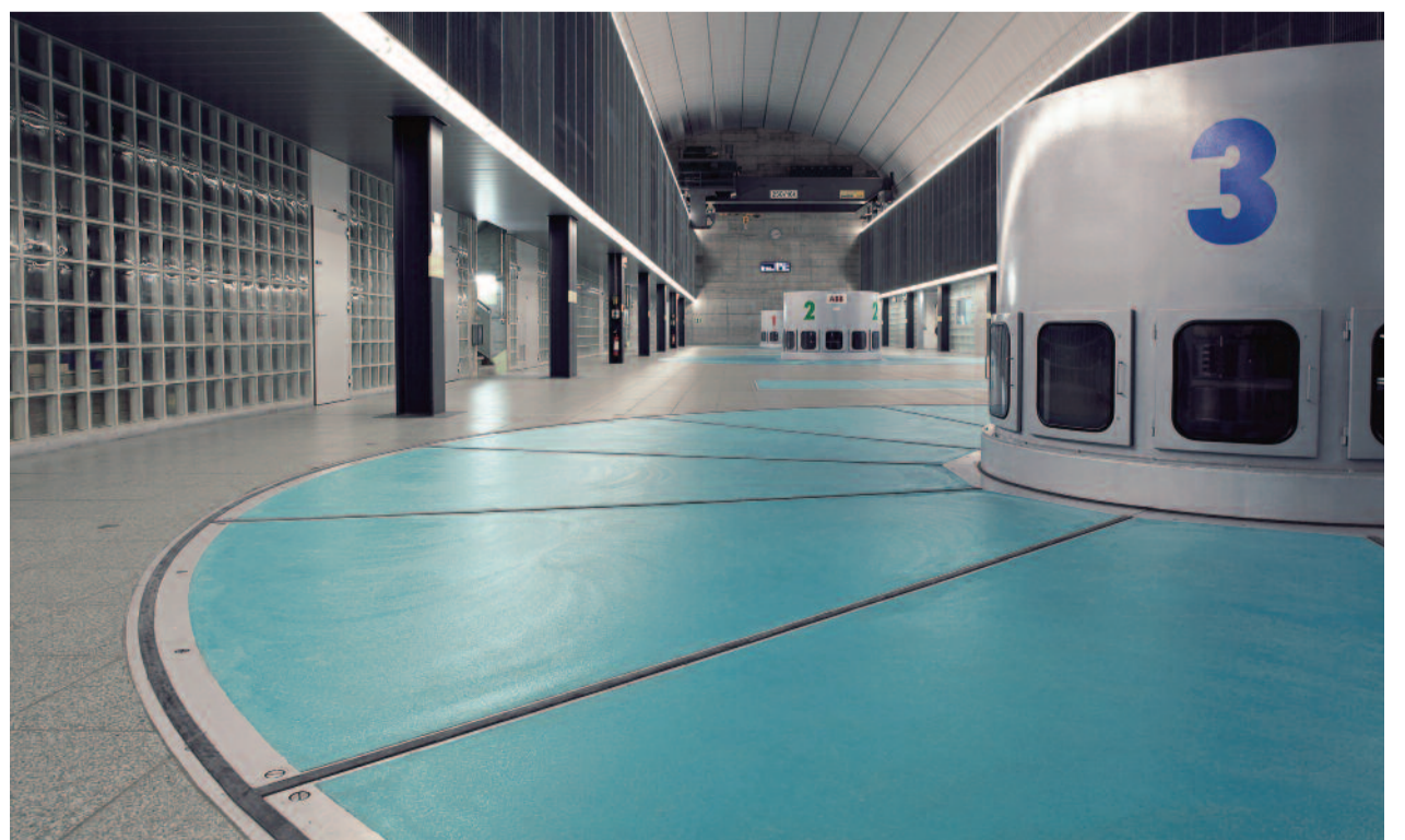
Blitzsaubere unterirdische Maschinenhalle des Kraftwerkes Bieudron (Teil der Grande Dixence).
